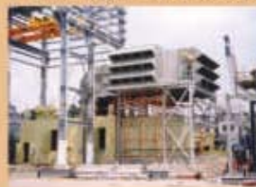
▼ BKK Cogen - Gas Turbine 6EA
