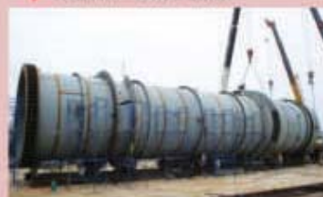
▼ Astoria - HRSG Stack
